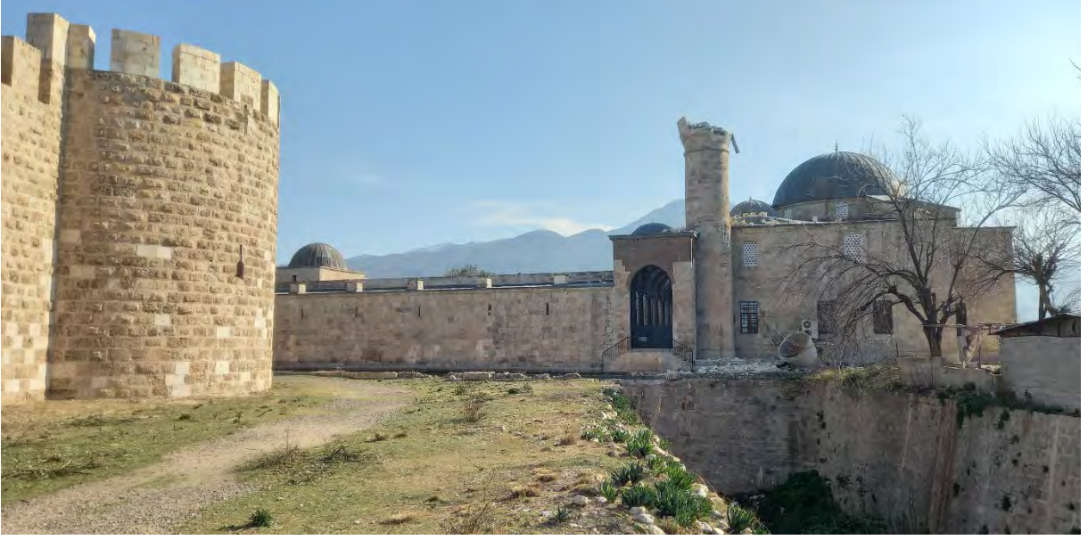
Payas Sokollu Camisi'nde deprem sonrası gözlenen hasarlar (Fotoğraf: Doç. Dr. Koray Güler)
