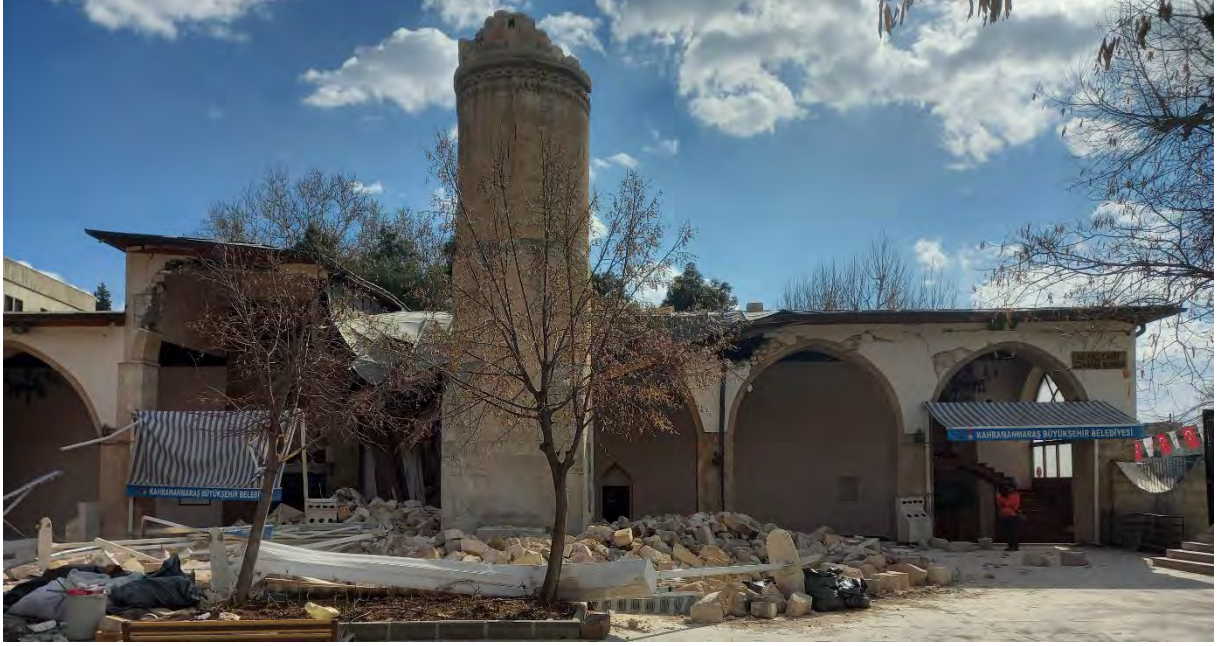
Kahramanmaraş Ulu Camisi'nde deprem sonrası gözlenen hasarlar (Fotoğraf: Doç. Dr. Koray Güler)
