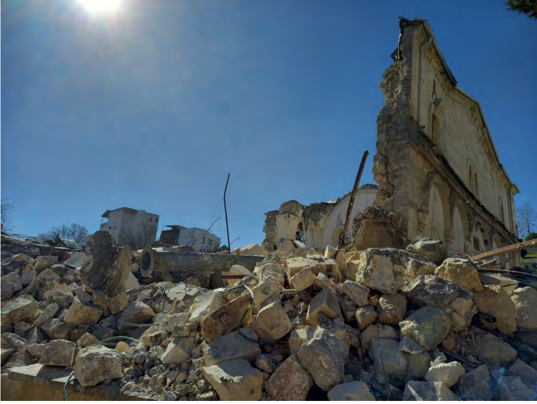
Adıyaman Ulu Camisi'nde deprem sonrası gözlenen hasarlar (Fotoğraf: Doç. Dr. Koray Güler)
