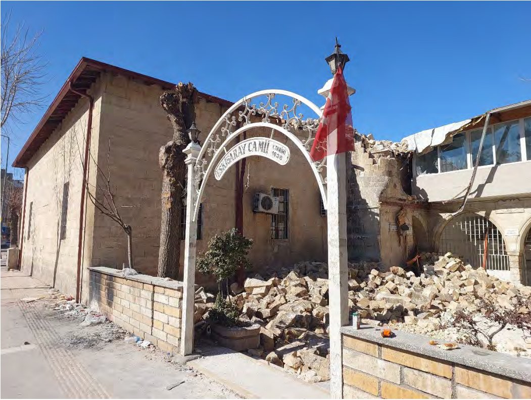
Adıyaman Eski Saray Camisi'nde deprem sonrası gözlenen hasarlar
