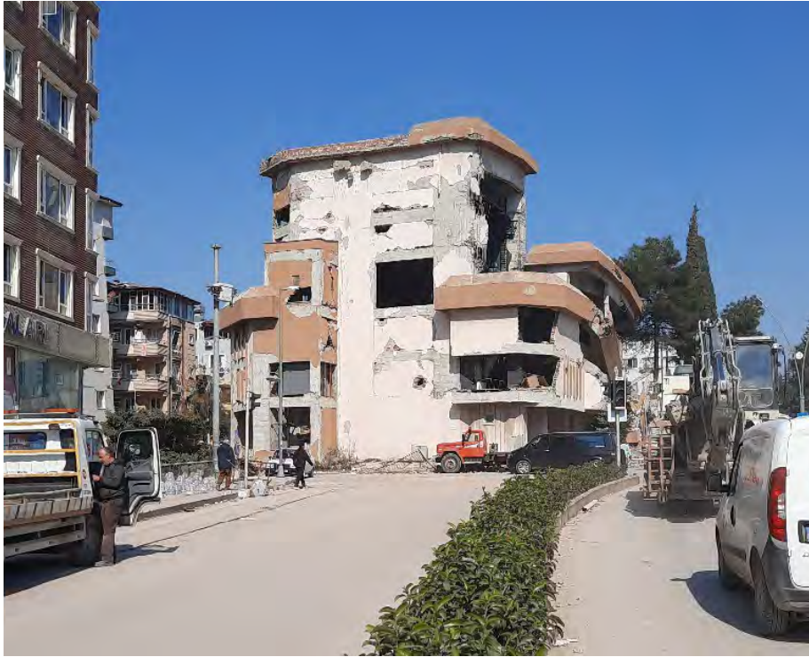
Hatay Kültür Merkezi 6 Şubat 2023 depremleri sonrası hasar
