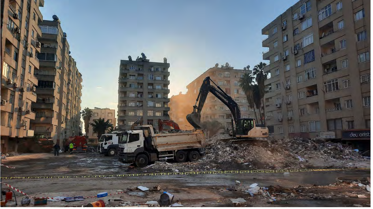
Osmaniye - Metin Tamer Sitesi deprem sonrası
