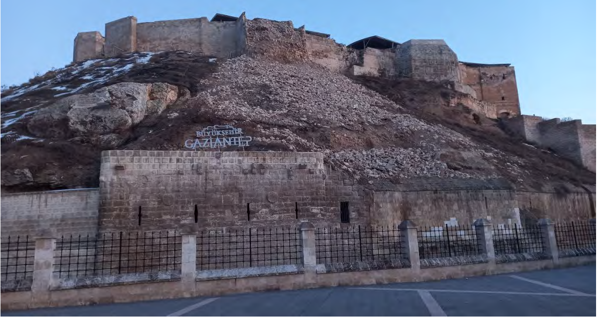
Gaziantep Kalesi'nde deprem sonrası gözlenen hasarlar (Fotoğraf: Doç. Dr. Koray Güler)
