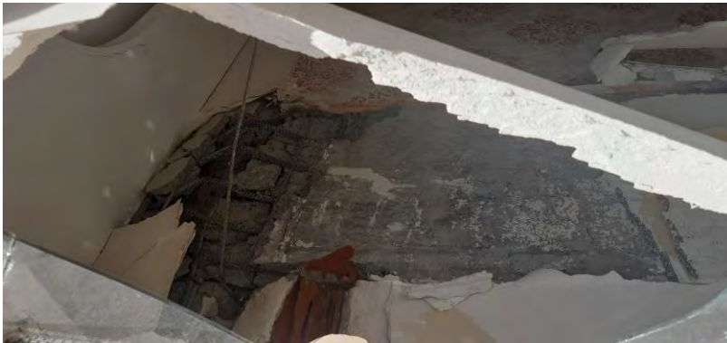
Betonarme çok katlı yapılardan hasar detayları
