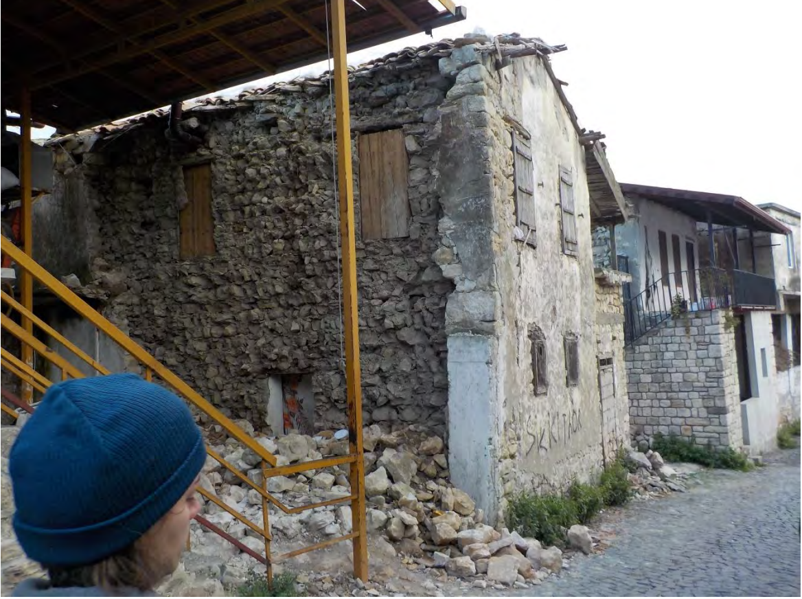
Hatay, Samandağ İlçesi, Hıdırbey Köyü dış cidarı dökülmüş taş duvar
