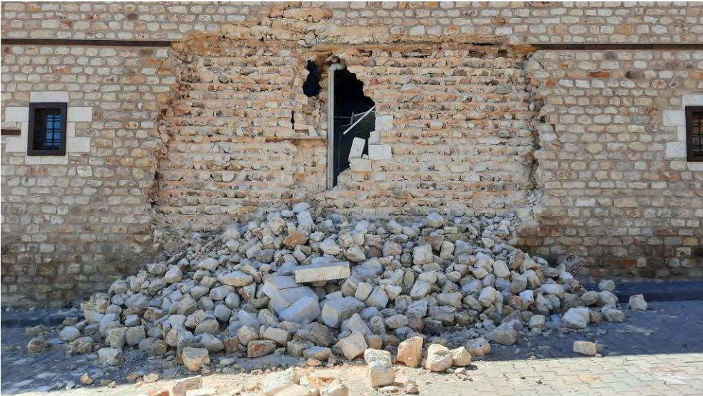
Restore Edilmiş Ancak Yıkık / Ağır Hasarlı Durumdaki Yapılar, Adıyaman
