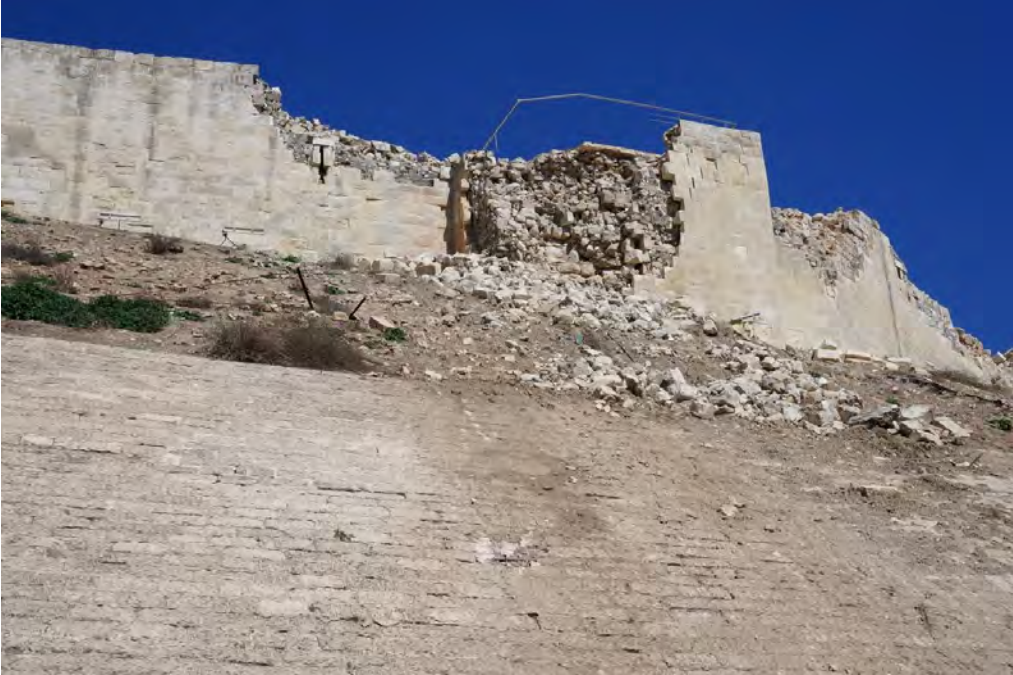
Gaziantep Kalesi burçlarında ve duvarlarında hasarlar
