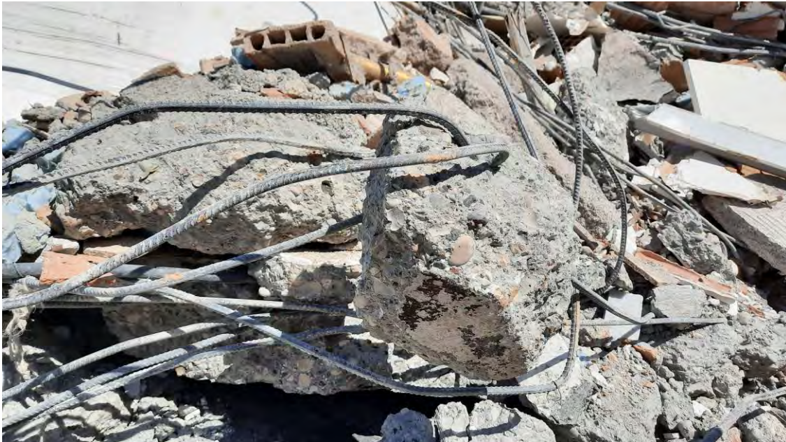
Adıyaman Altınşehir'de Yapısal Hasarlar
