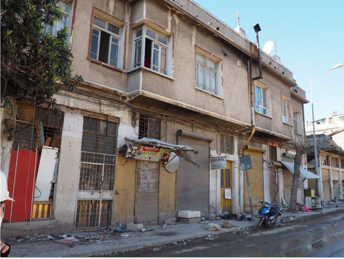
Kurtuluş Caddesi, olasılıkla 1930-40'lı yıllara tarihlenen yığma tuğla duvarlı, betonarme döşemeli yapı
