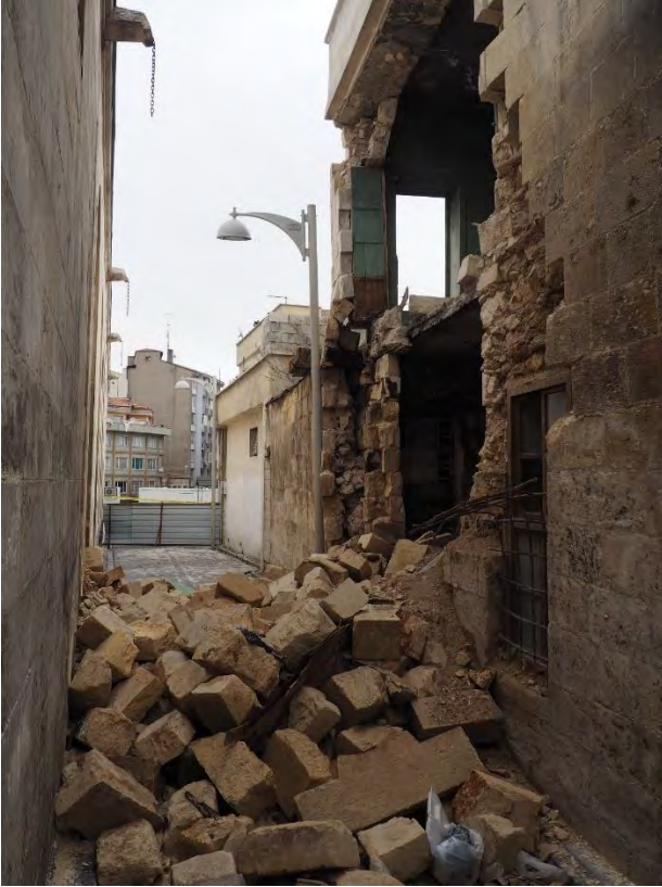
Bey Mahallesinde bir evin duvarı sokağa doğru yıkılmış
