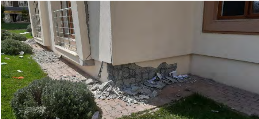
Betonarme Çok Katlı Yapılarda Hasar Detayları
