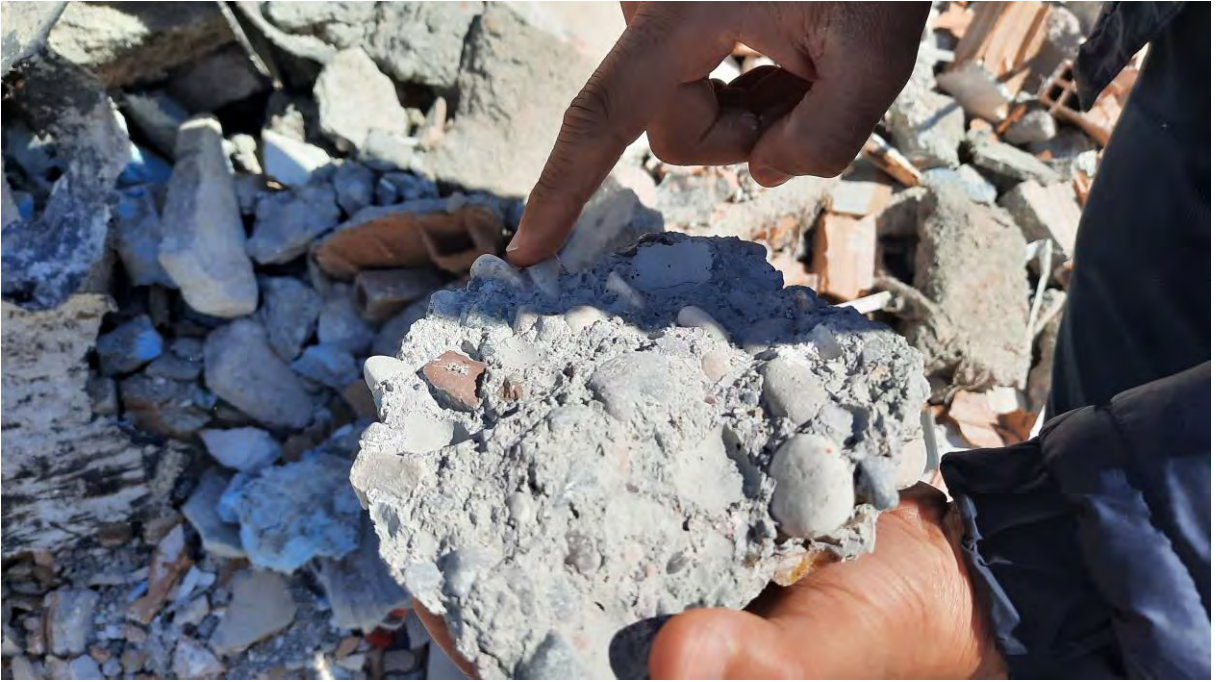
Yapısal Hasarlar, Beton ve Donatı Örnekleri
