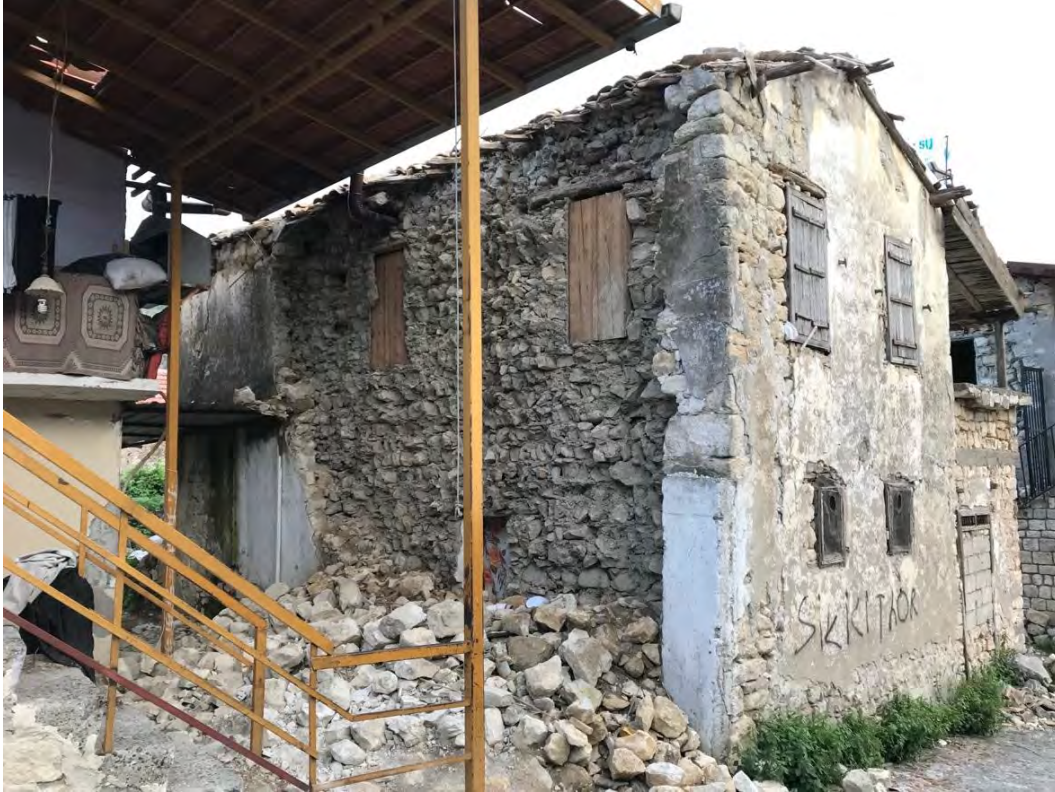
Hatay, Samandağ İlçesi, Hıdırbey Köyü'ndeki sivil mimari örneklerinde kagir duvarlarda görülen hasarlar
