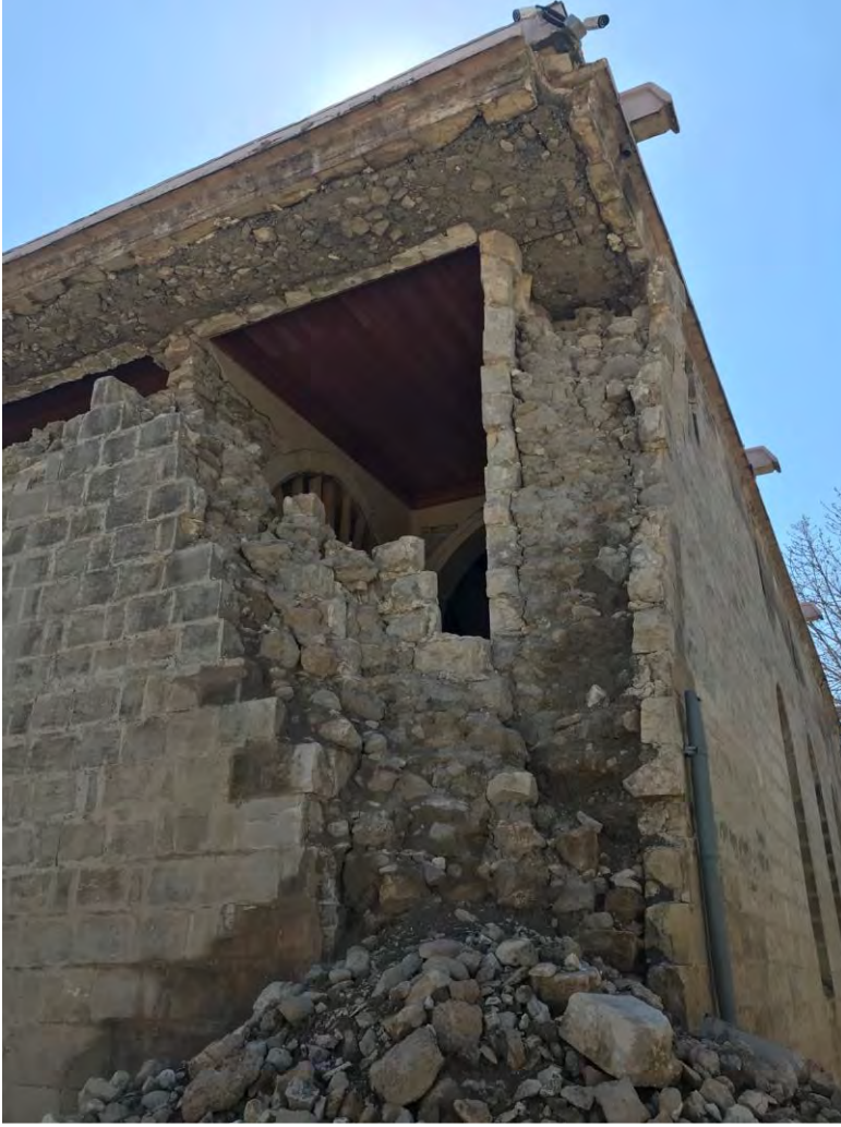
Adıyaman Mor Petrus Ve Mor Paulus Kilisesi kuzeydoğu köşesinde hasarlar
