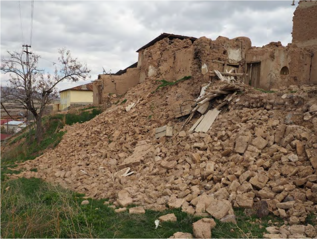
Balaban, duvarları yıkılmış yapı
