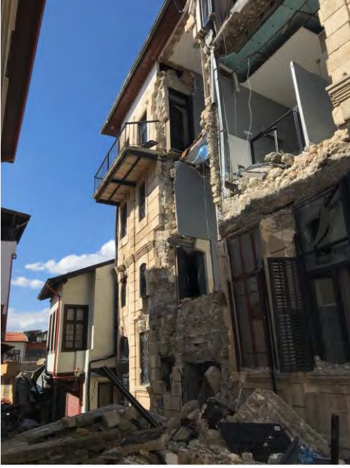
Antakya, Kurtuluş Caddesi'nde düzlem dışı hasarlara örnek
