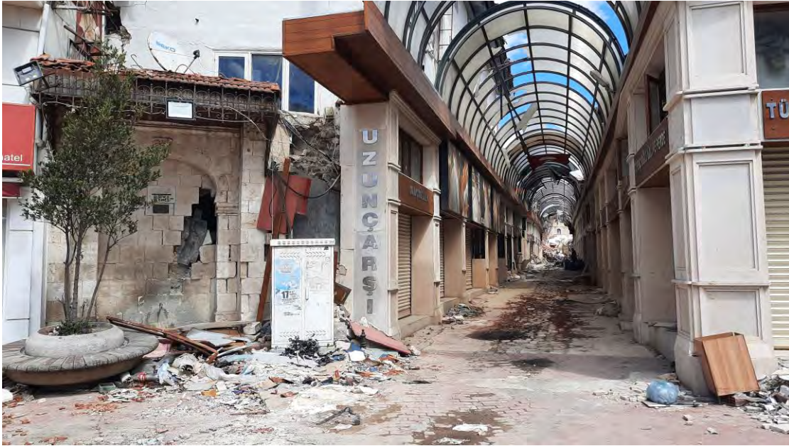
Tarihî Kent Merkezi ve Yeni Yapılaşma Alanları Hasar Örnekleri
