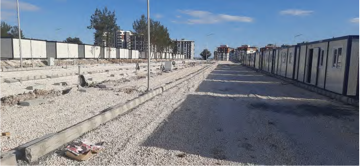
Prefabrik yerleşim alanları ve gözlenen sorunlar
