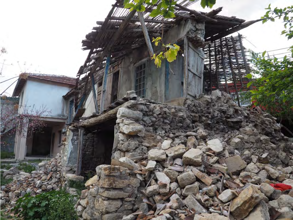
Hatay, Samandağ İlçesi, Hıdırbey Köyü, yıkılmış taş yapı
