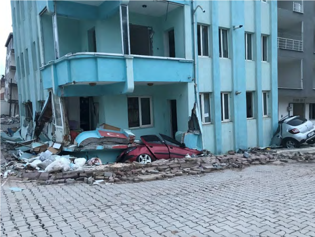
Adıyaman-Gölbasi'nda zemin sıvılaşması
