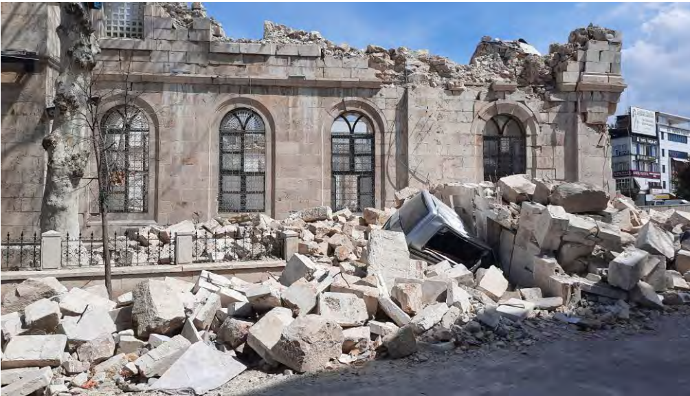
Restore Edilmiş Ancak Yıkık / Ağır Hasarlı Durumdaki Yapılar, Malatya
